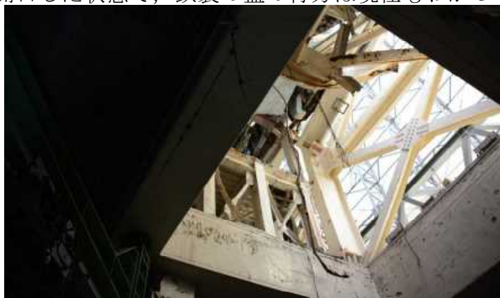
写真8 5階大物搬入口（4階天井）の状況（原子力規制庁出水現地調査報告書より）
