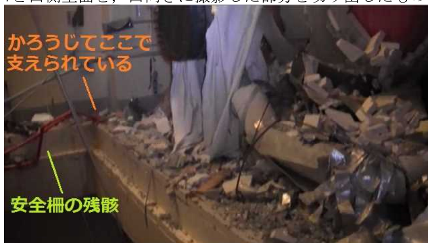
写真4 4階大物搬入口北側安全柵が失われた状況（被告2011年10月18日撮影ビデオより）
