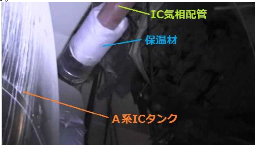
写真11 非常用復水器北側の保温材脱落状況（被告2011年10月18日撮影ビデオより）
