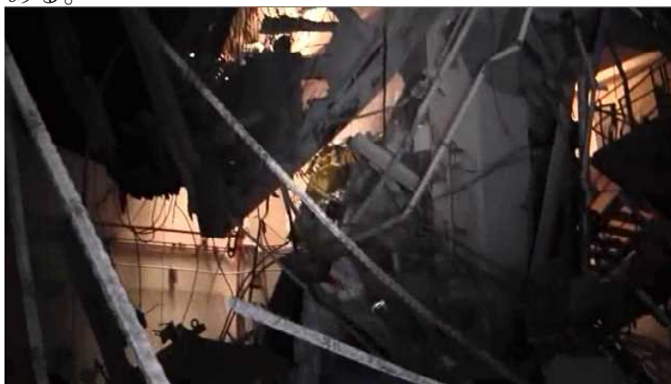
写真9 原子炉建屋4階北側天井の破損開口部の状況（被告2011年10月18日撮影ビデオより）
