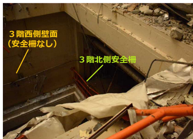
写真6 3階大物搬入口西側及び北側の状況（原子力規制庁出水現地調査報告書より）
