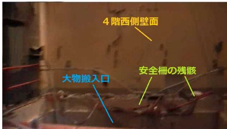
写真5 大物搬入口西側に北側安全柵が移動した状況（被告 2011 年 10 月 18 日撮影ビデオより）
