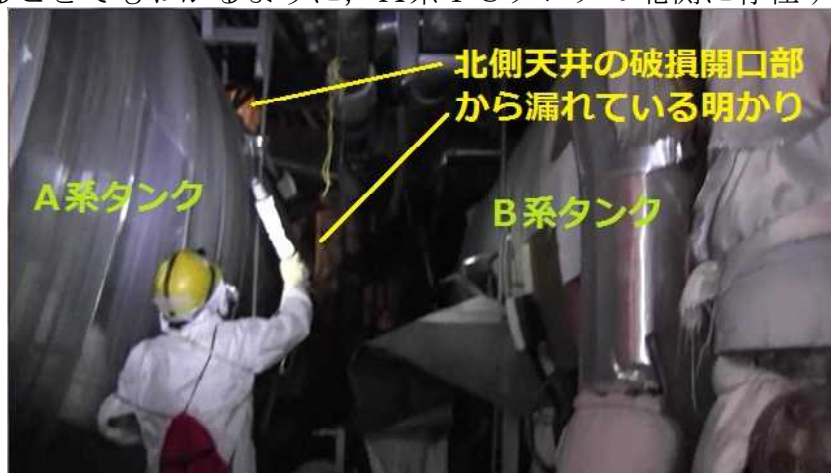
写真10 原子炉建屋4階北側天井の破損開口部の位置（被告2011年10月18日撮影ビデオより）
