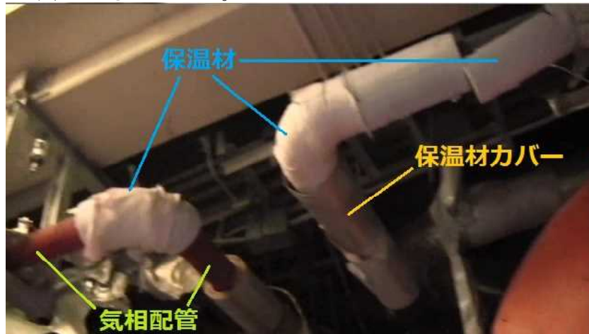
写真2 非常用復水器南側気相配管の保温材脱落状況（被告2011年10月18日撮影ビデオより）
